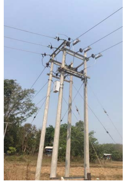
11kV OH Line_13
