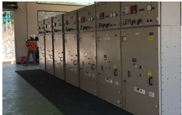
11kV Switch gear panel -01
